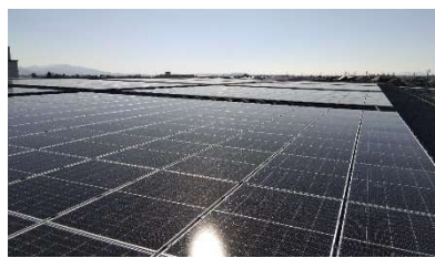
太陽光パネル(2024 年 8 月設置)
