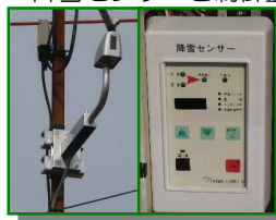
～降雪センサーと制御盤～
